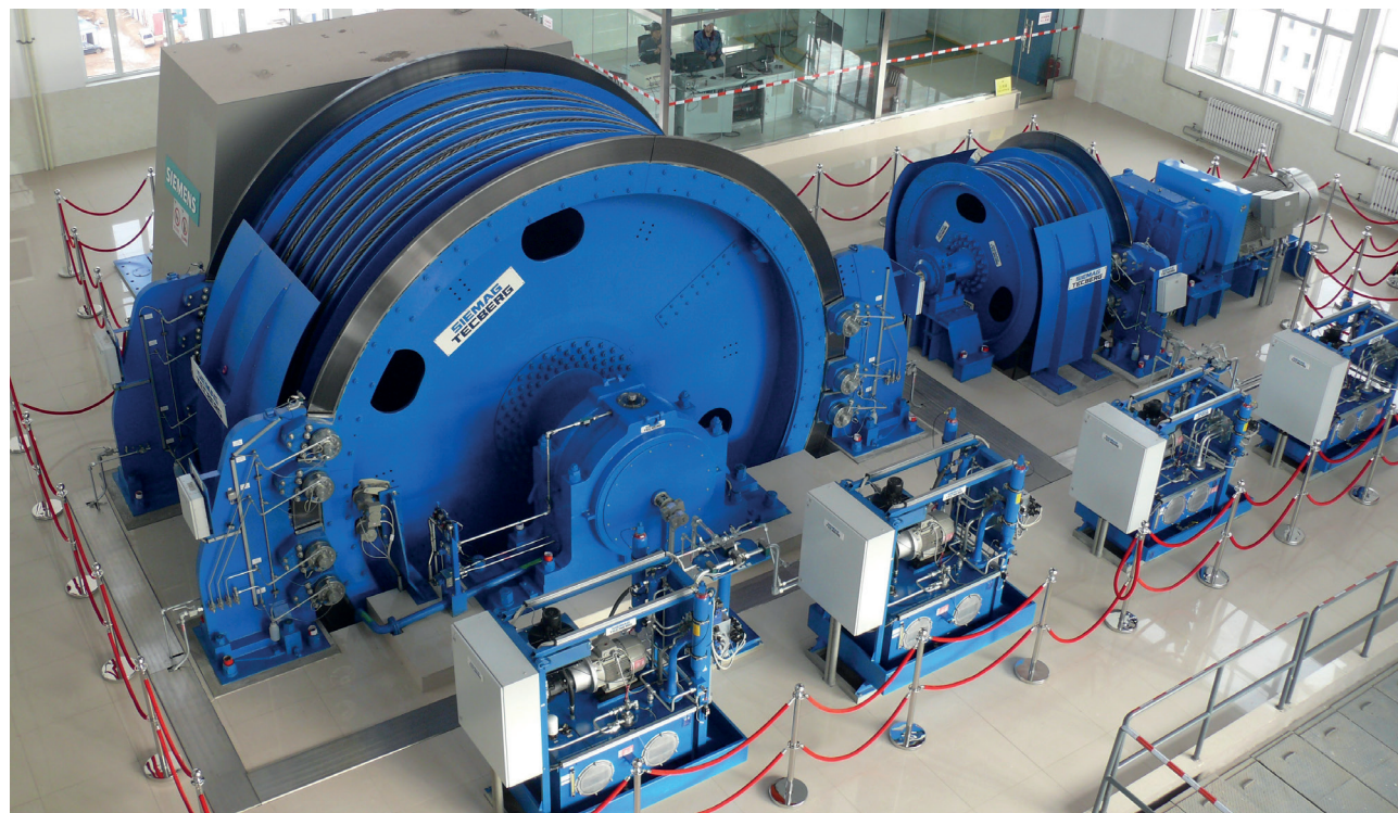
Rys. 2: Zdjęcie referencyjne 6-linowej maszyny wyciągowej Koepe firmy SIEMAG TECBERG zainstalowanej na wieży. Copyright 2022 Tianjin SIEMAG TECBERG.
