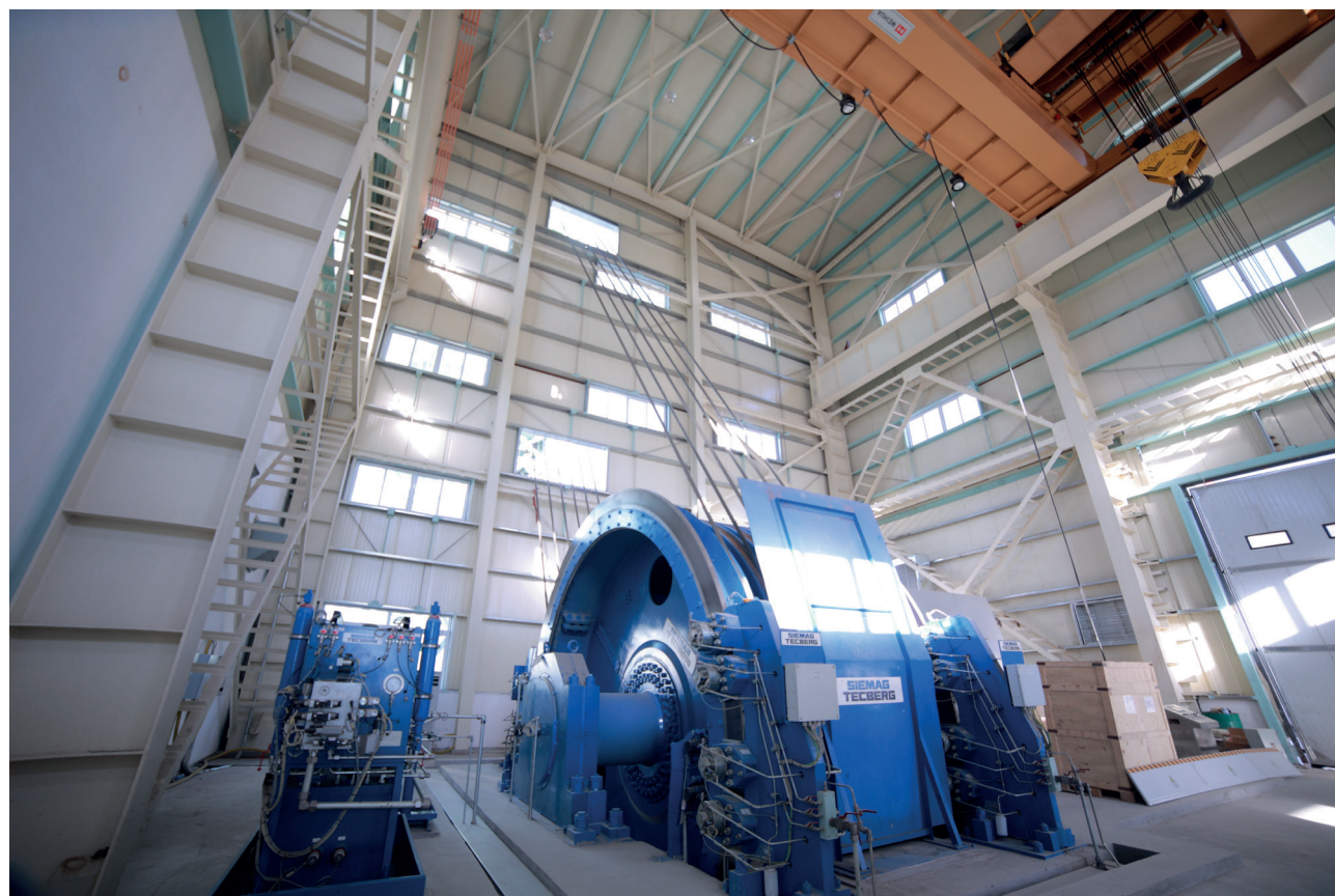
Rys. 1: Już w eksploatacji - 6-linowa maszyna wyciągowa typu Koepe szybu serwisowego.
