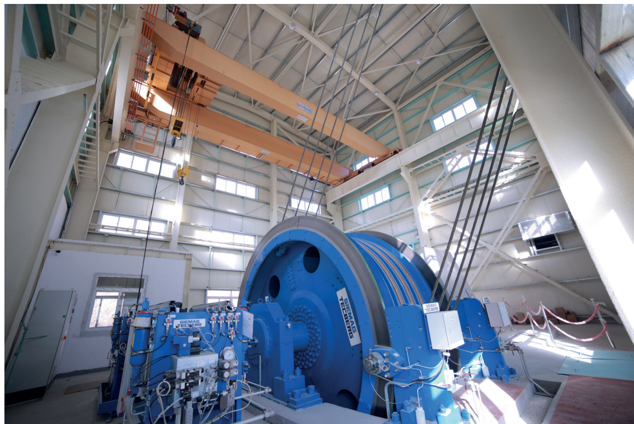
Rys. 2: Również już działająca - 4-linowa maszyna wyciągowa typu Koepe szybu serwisowego.
